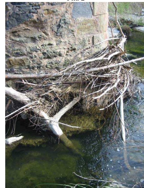
Detalle zona erosionada cimentación de Pila
